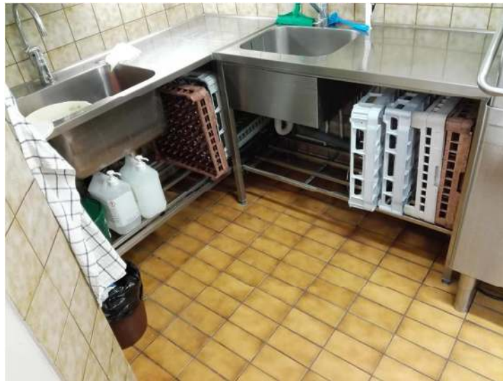
Lattiakaadot ovat kastuneen väliseinään päin.
