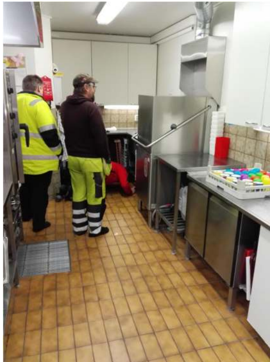
Kohonneita kosteusarvoja havaittu lattiassa kastuneen väliseinän edestä.
