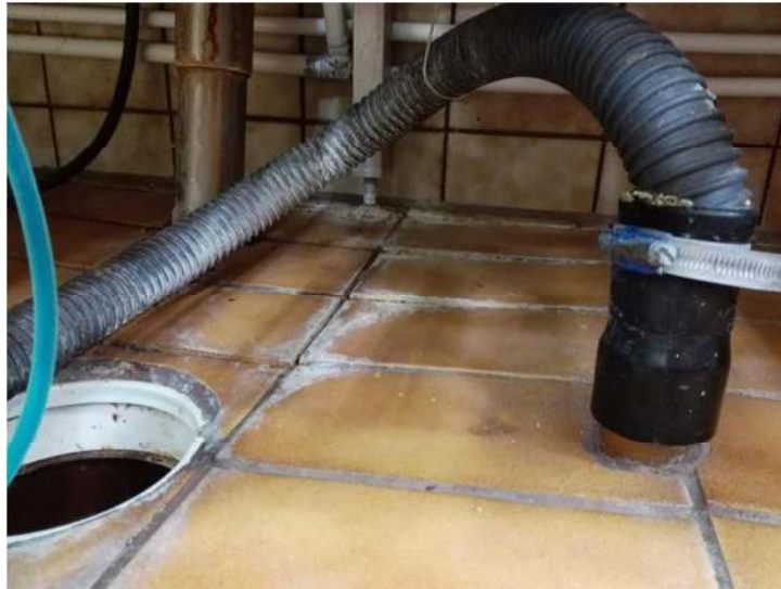
Klinkkerisaumat ovat olemattomia lattiakaivon vierestä.
