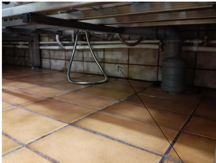
Keittiön ja teknisen tilan välinen seinä on kastunut alaosastaan noin 3 m matkalta.
