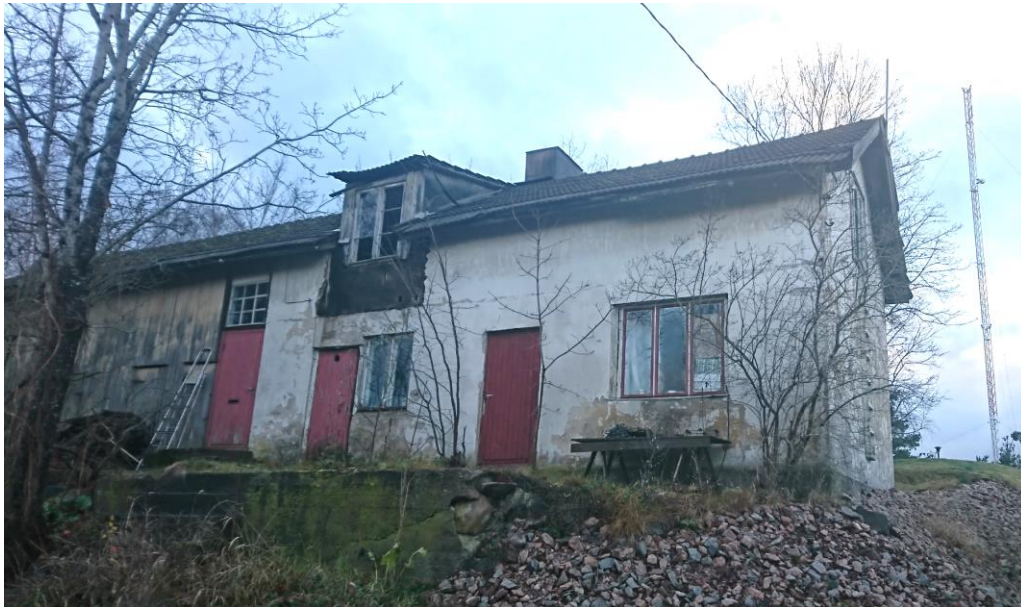
Tontin takaosassa sijaitseva huonokuntoinen rakennus, jota on käytetty sekä asuntona että varastona.
