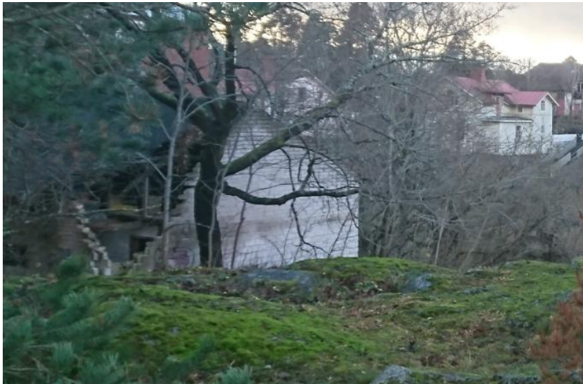
Talousrakennuksen sementtitiilistä vuorattu pohjoispääty on osittain sortunut.
