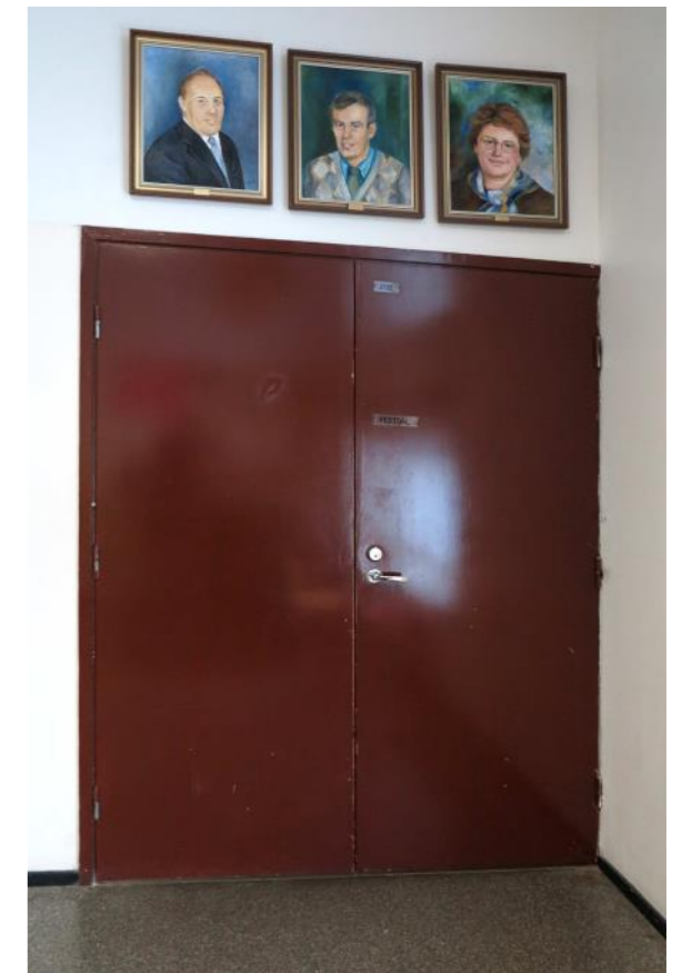
Salin portaikkoon avautuva pääovea on nykyään ilmeeltään koruton maalattu teräsovi. Ovi on uusittu vuoden 1978 korjauksen yhteydessä. Tämän selvityksen yhteydessä ei ole löytynyt alkuperäisiä piirustuksia, josta voisi päätellä alkuperäisen oven tyyppiä. Oven päällä on koulun rehtorien muotokuva-sarja.
