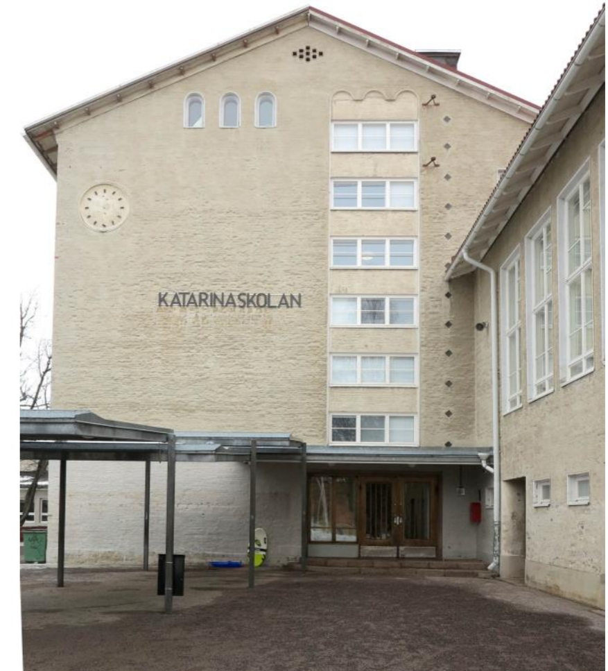
Vanhan pääsisäänkäynnin katokseen on vuoden 1992 muutostöiden yhteydessä liitetty uusi porrastuva suurikokoinen sadekatos. Julkisivussa tunnusomaisen kellon viisarit on poistettu.
