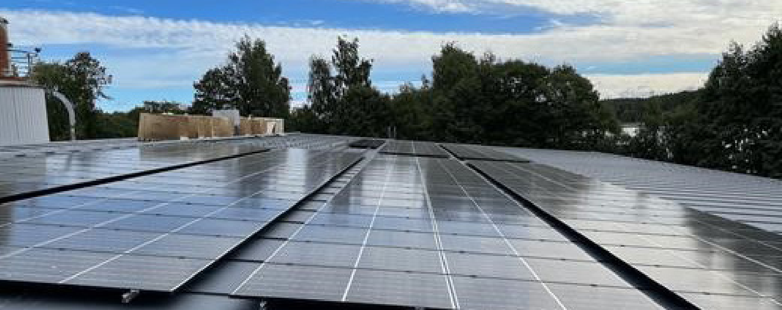
Solpaneler vid Skeppsholmens reningsverk / Dan Söderlund
